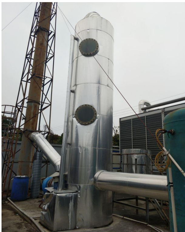
图 4-3 本项目主要废气治理设施 1（喷淋）
