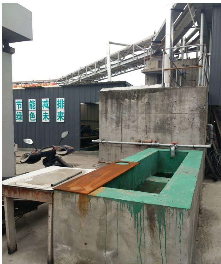
图 4-2 本项目主要废水治理设施
