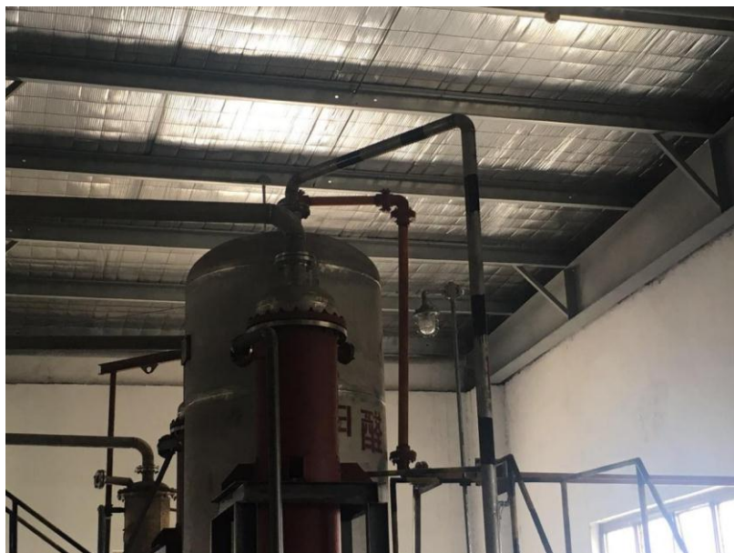
图 4-6 本项目主要废气治理设施 4（合成罐体顶部的回吸管）
