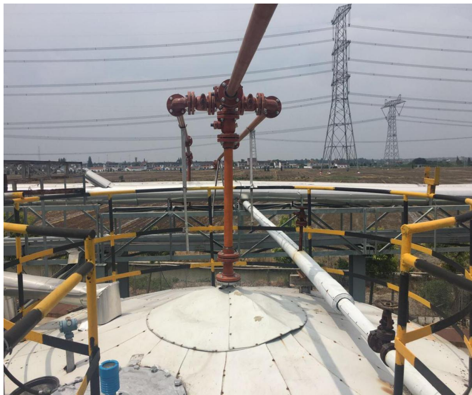
图 4-8 本项目主要废气治理设施 6（储罐区罐子顶部的平衡呼吸管）
