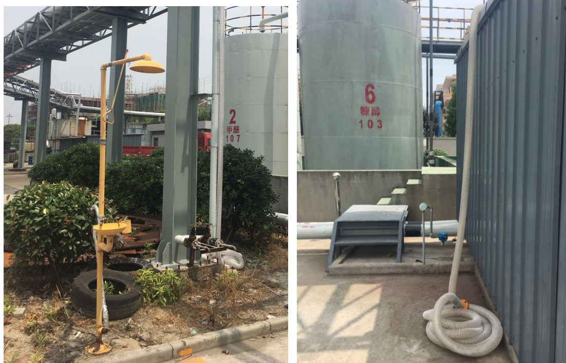
图 4-9 本项目主要废气治理设施 7（平衡呼吸管）
