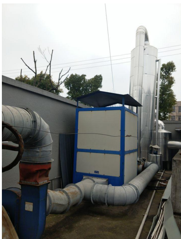
图 4-4 本项目主要废气治理设施 2（焚烧+喷淋）
