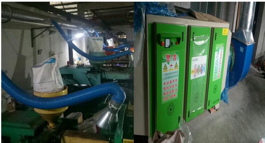
图 4-2 本项目有机废气处理设施图片
