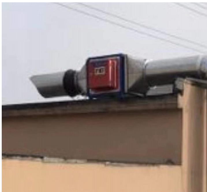
图 4-2 本项目油烟废气治理设施图片
