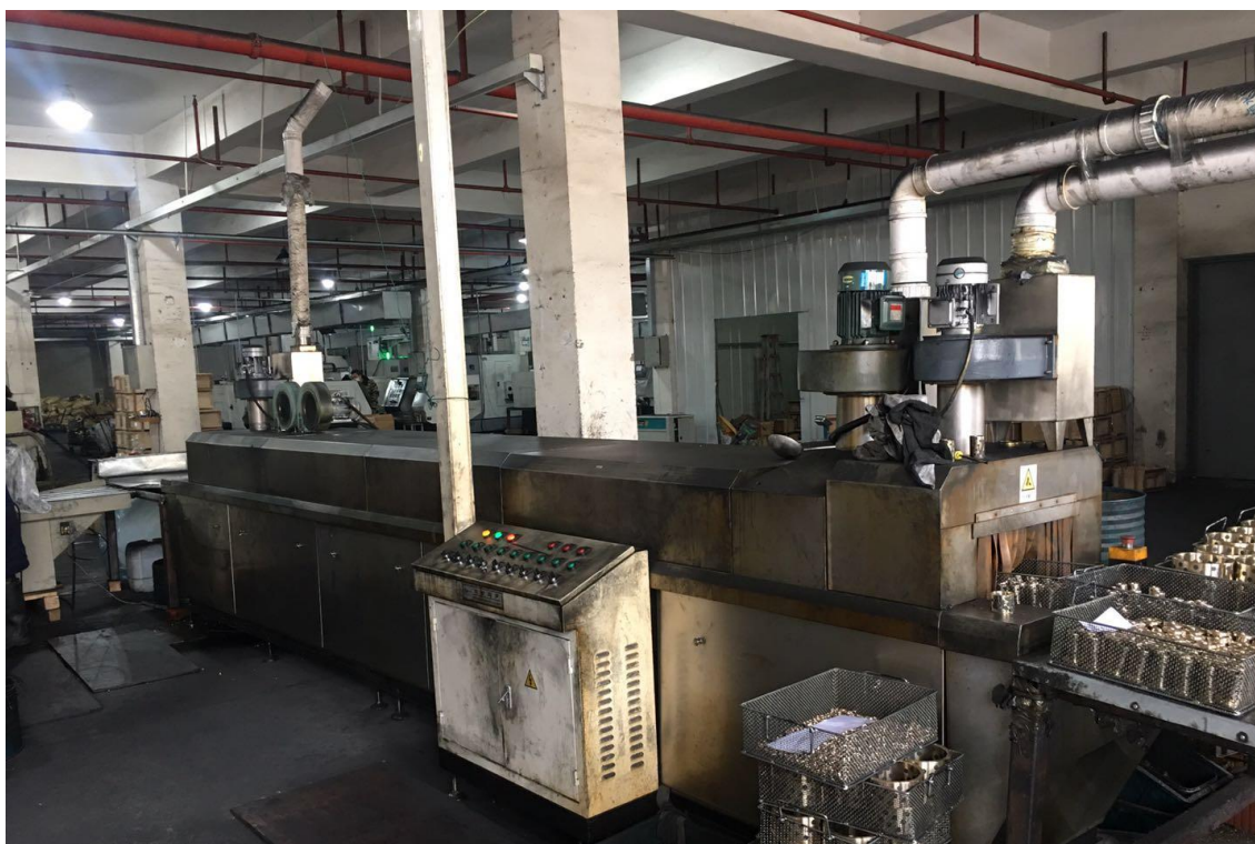
图4-1 废气收集设施图片
