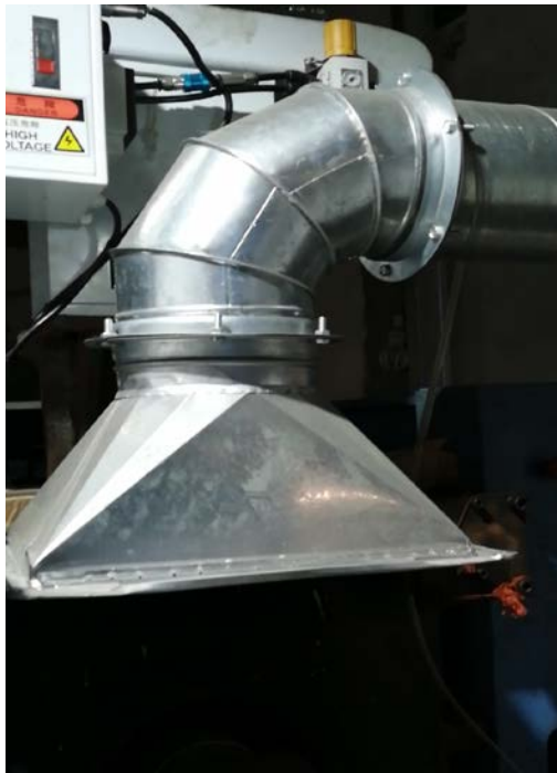
图4-2 废气收集设施
