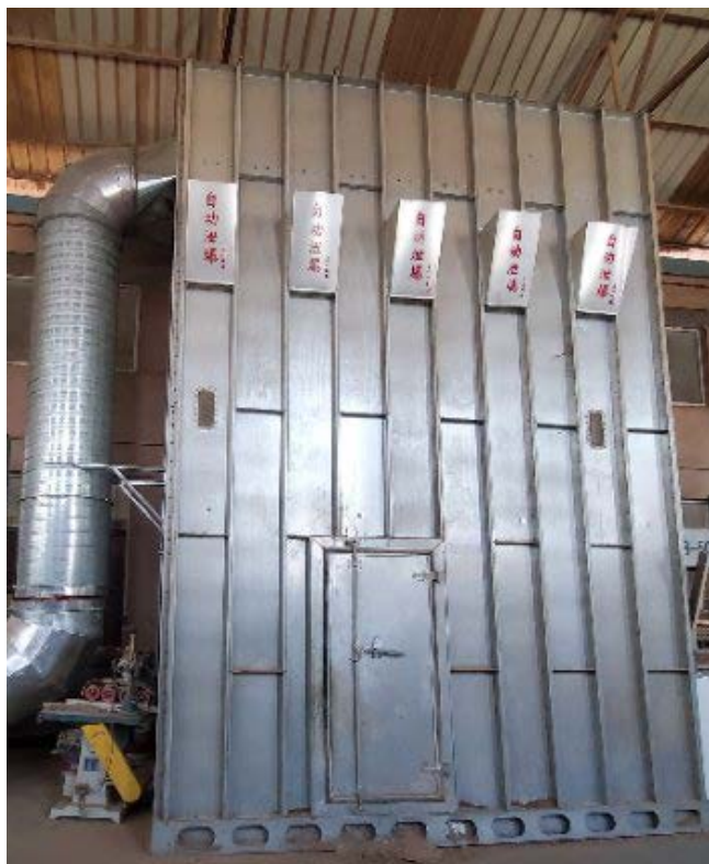
粉尘处理设施
