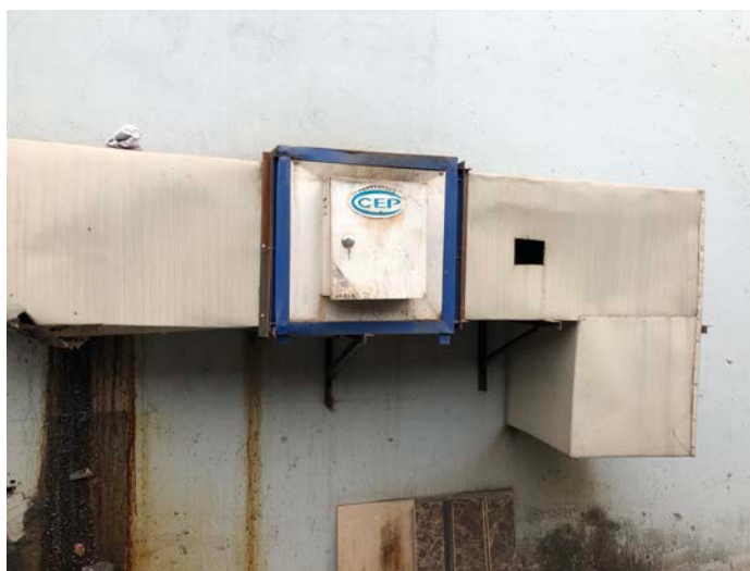
油烟废气处理设施
