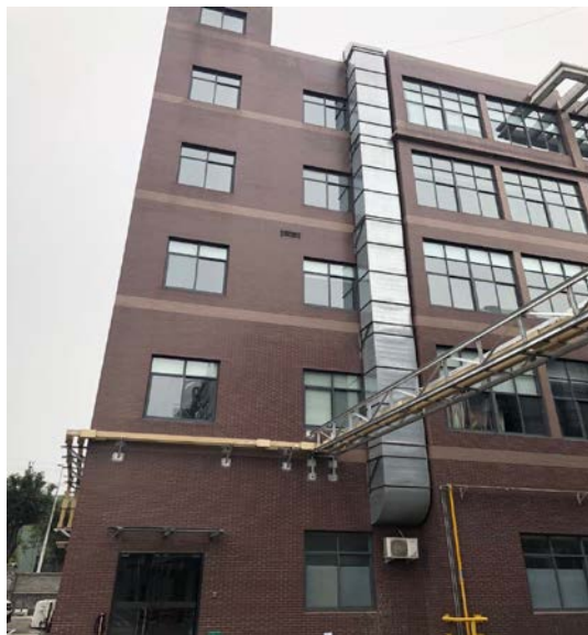
图 4-6 本项目主要废气治理设施（食堂油烟）
