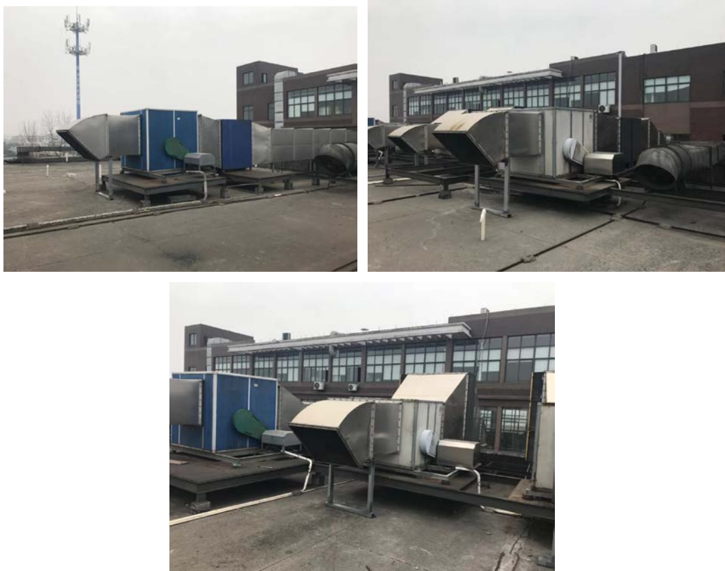
图 4-5 本项目主要废气治理设施（油烟净化器）
