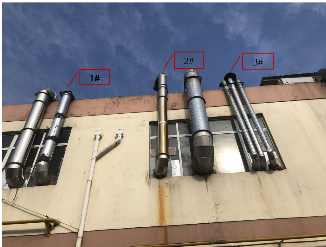
图4-2 本项目废气治理图片
