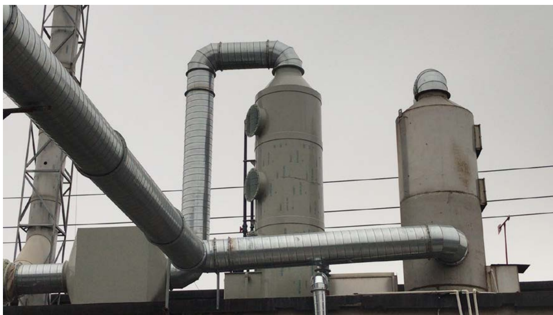
图 4-4 本项目主要废气治理设施（喷漆、整烫定型废气）
