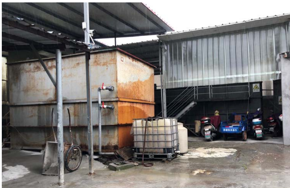
图 4-2 本项目主要废水治理设施
