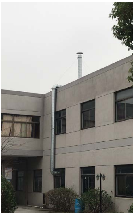
图 4-5 本项目主要废气治理设施（注塑废气）
