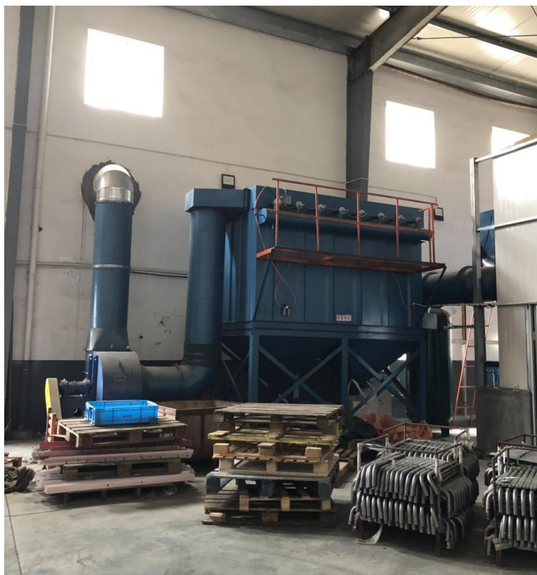
图 4-5 本项目抛丸粉尘处理设施图片（西南车间 1 楼）
