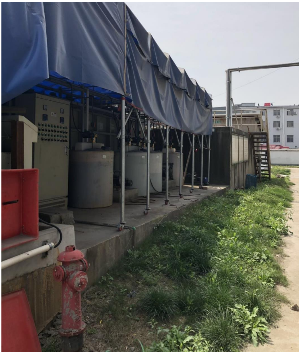
图 4-2 生产废水处理设施图片
