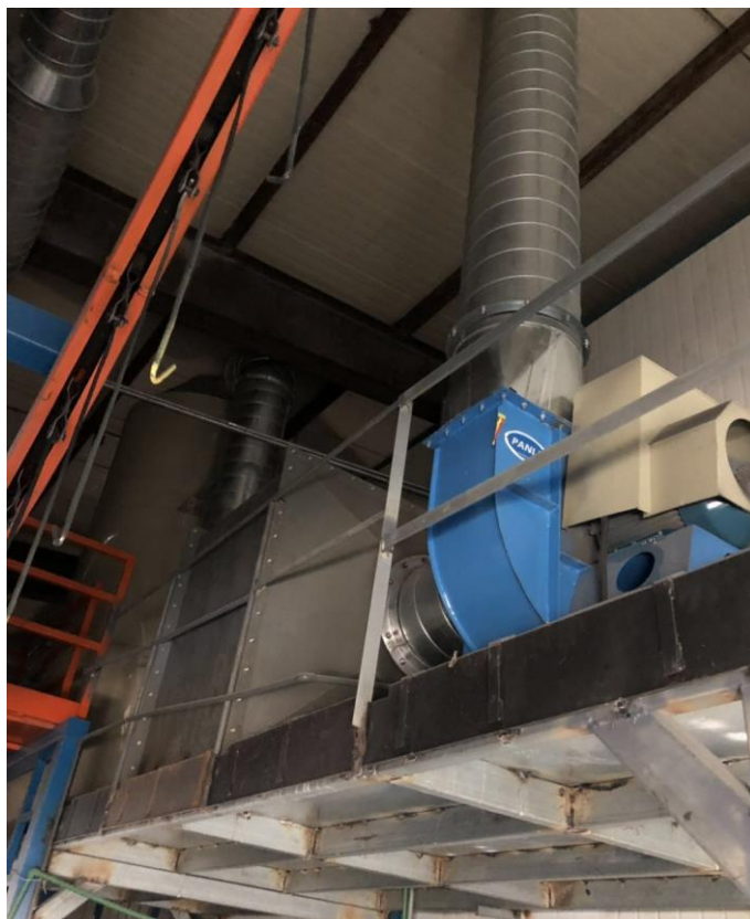
图 4-10 本项目喷塑粉尘处理设施图片（东面车间）
