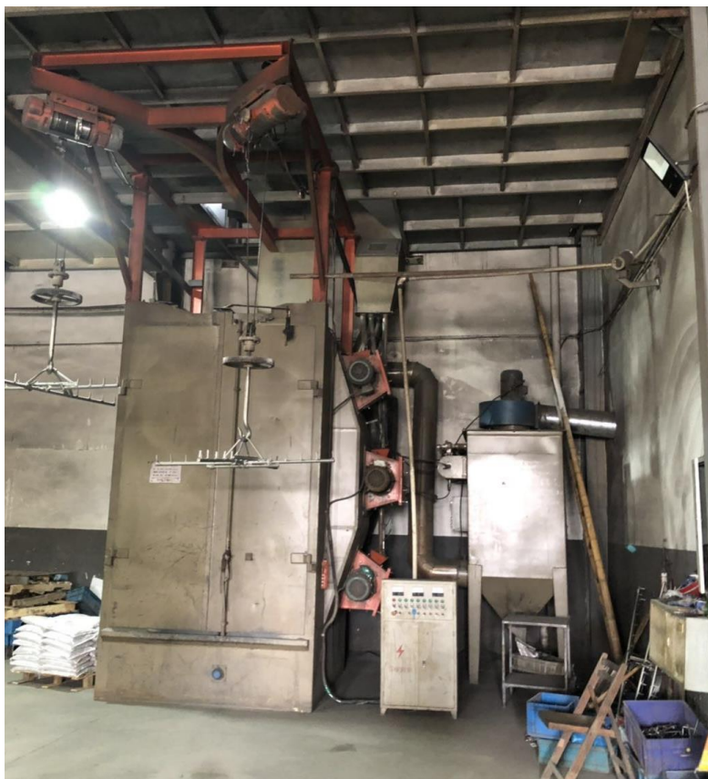
图 4-4 本项目抛丸粉尘处理设施图片（东面车间 1 楼）
