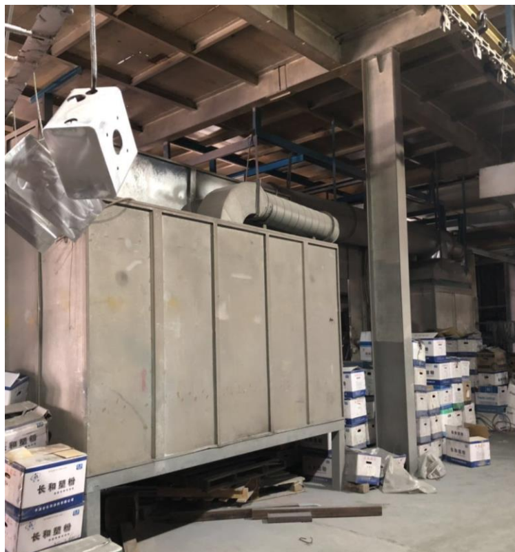
图 4-6 本项目喷塑粉尘处理设施图片（东面车间 1 楼）
