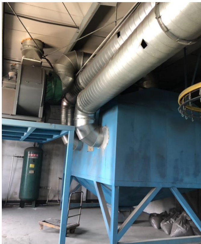
图 4-8 本项目喷塑粉尘处理设施图片（西北面车间二楼）
