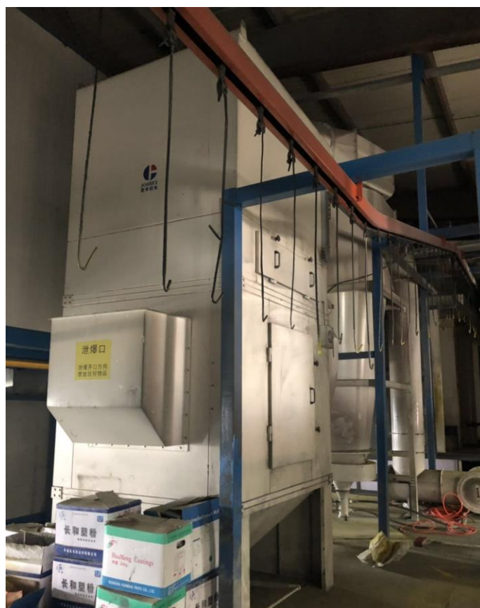
图 4-7 本项目喷塑粉尘处理设施图片（东面车间 2 楼）
