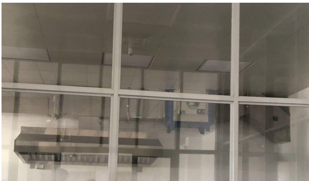
图 4-12 食堂油烟净化处理设施图片
