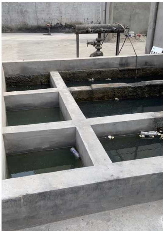
图 4-2 本项目主要废水治理设施
