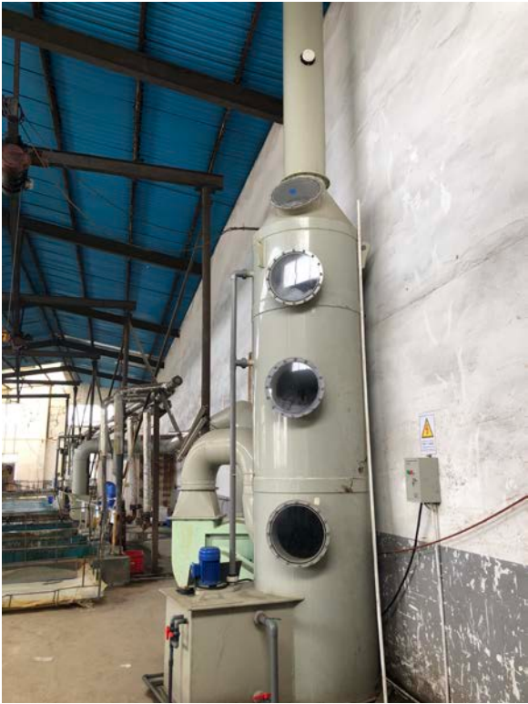
图 4-4 本项目主要废气治理设施（酸洗废气处理设施）
