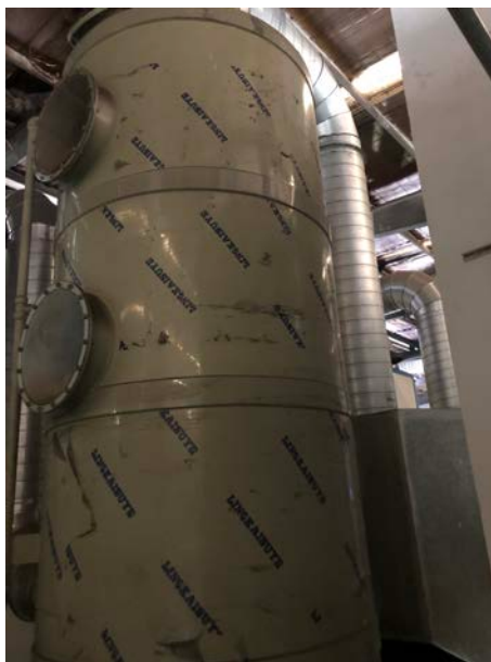
图 4-5 本项目主要废气治理设施（喷涂废气、燃气废气处理设施）
