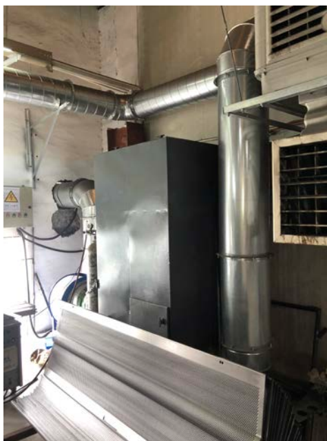
图 4-6 本项目主要废气治理设施（焊接、打磨废气处理设施）
