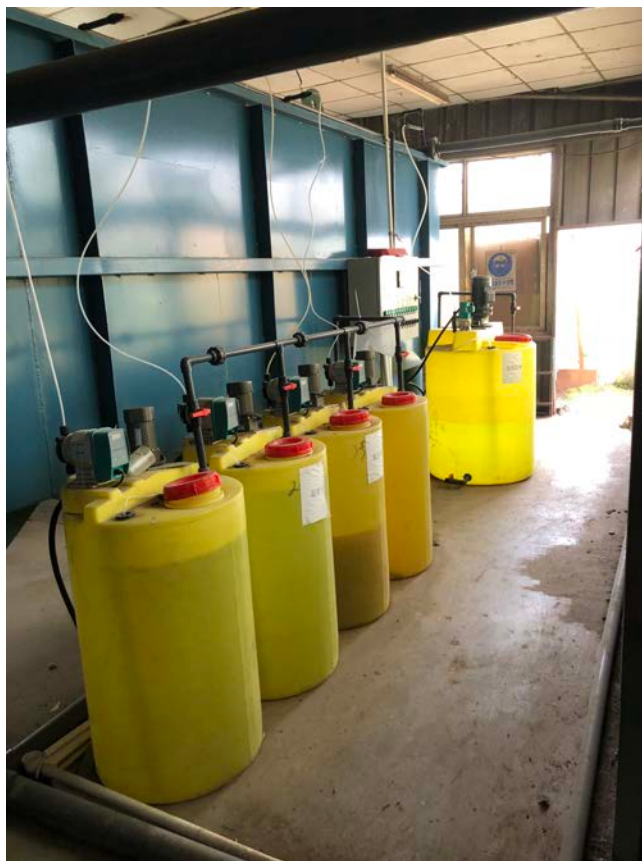
图 4-2 本项目主要废水治理设施
