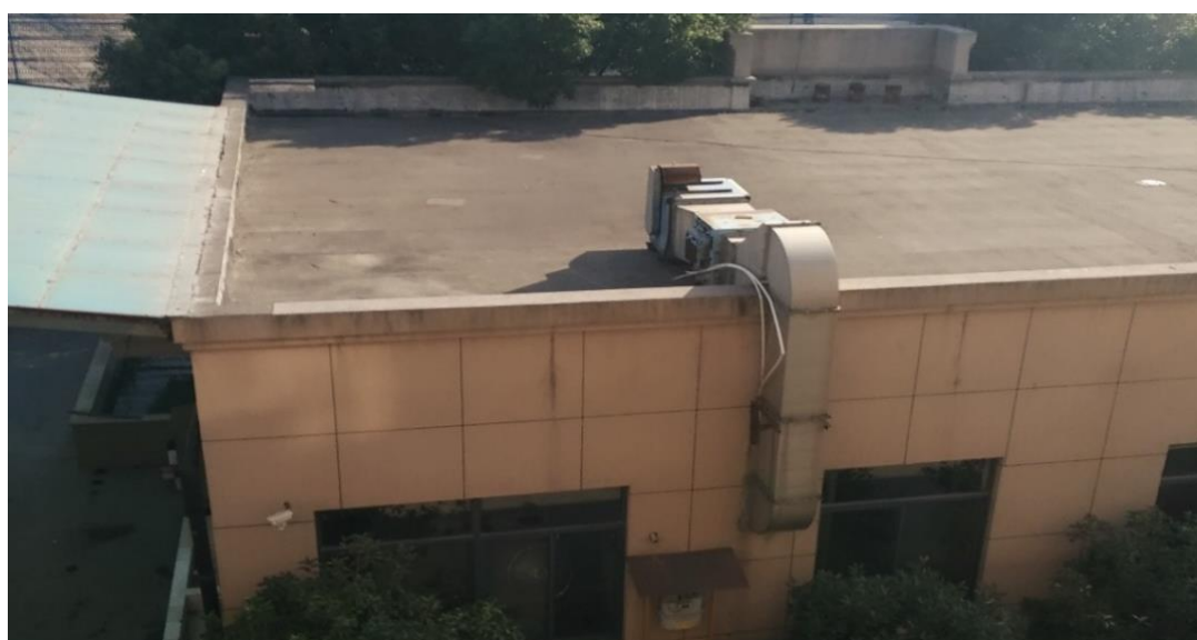
图4-4 食堂油烟处理装置
