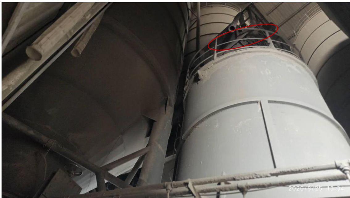
图4-7 筒仓废气治理设施
