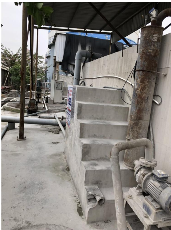
图 4-1 本项目生产废水处理站图片
