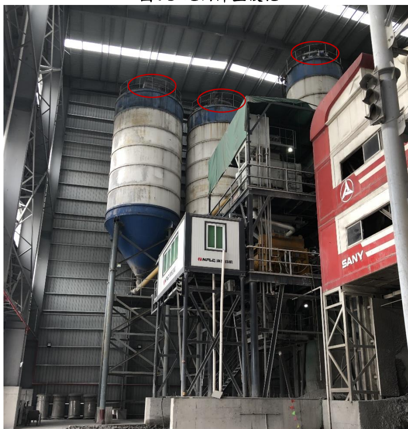
图4-4 筒仓处理设施
