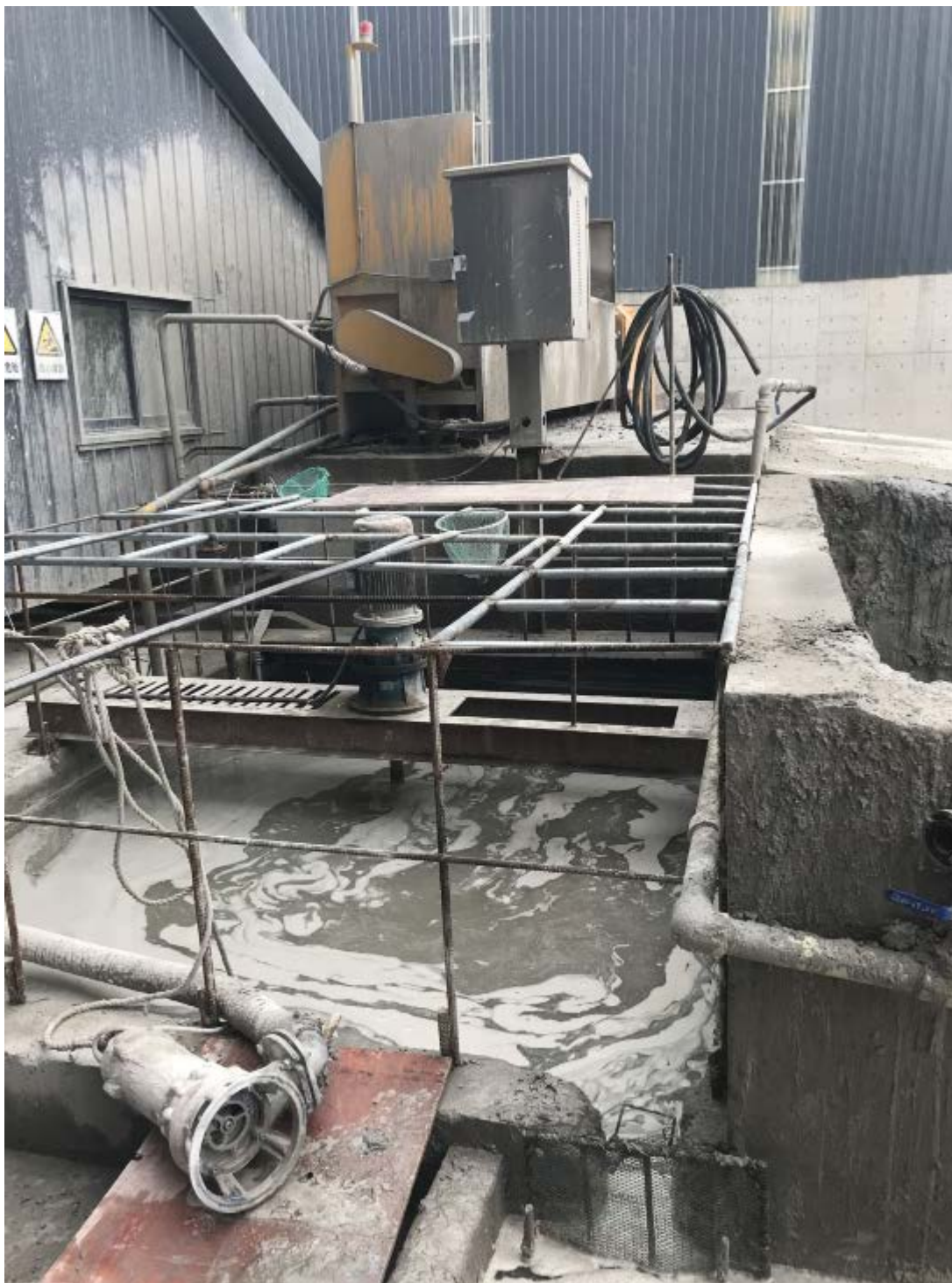
图 4-2 废水治理设施图
