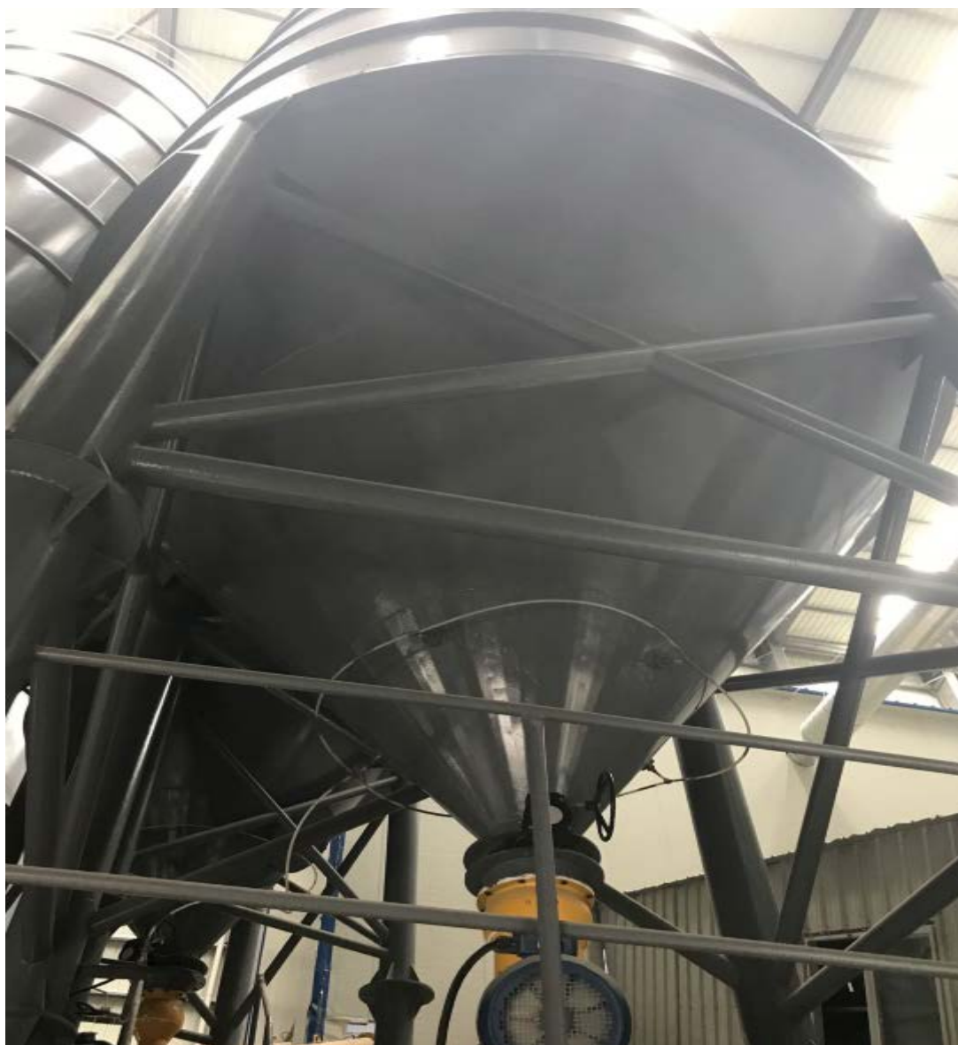
图 4-4 本项目主要废气治理设施 1（粉料筒仓顶脉冲反吹除尘）
