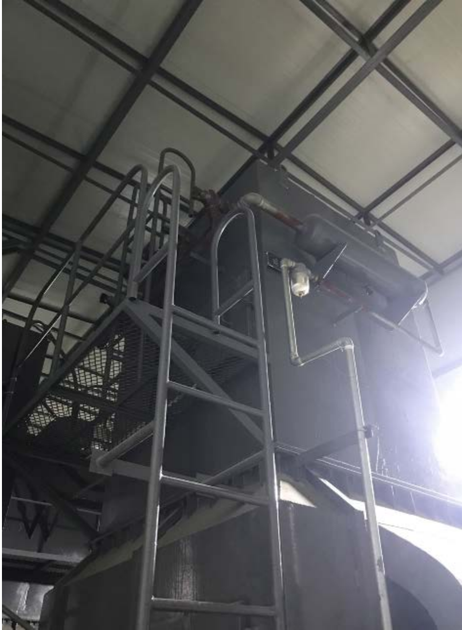
图 4-5 本项目主要废气治理设施 2（搅拌主机布袋除尘）
