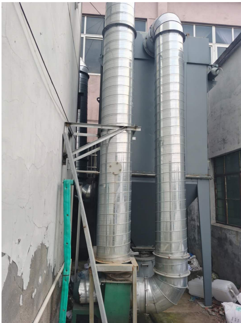
图 4-5 本项目投料粉尘治理设施图片
