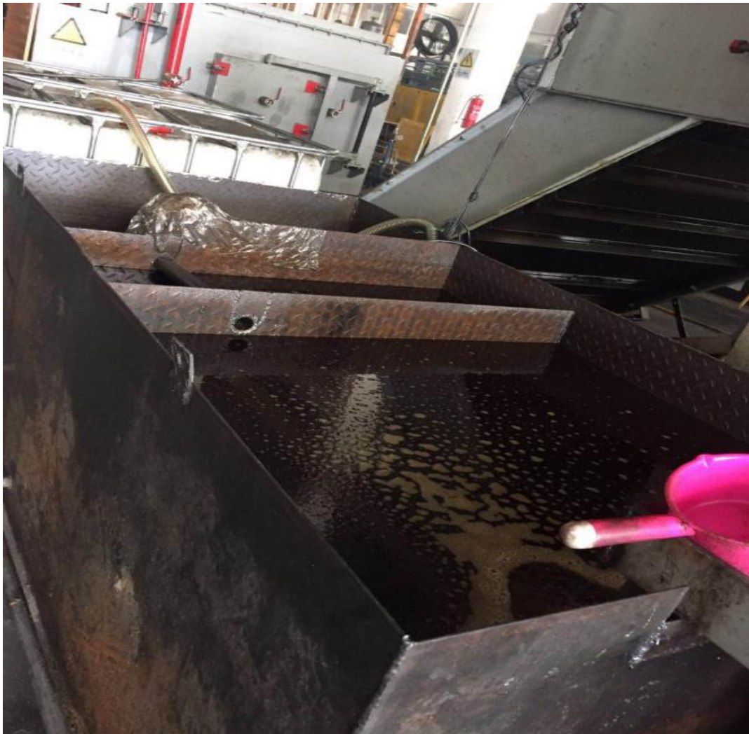
图 4-2 废水治理设施图
