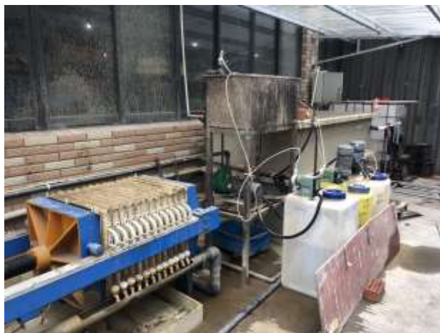
图 4-2 废水处理设施图
