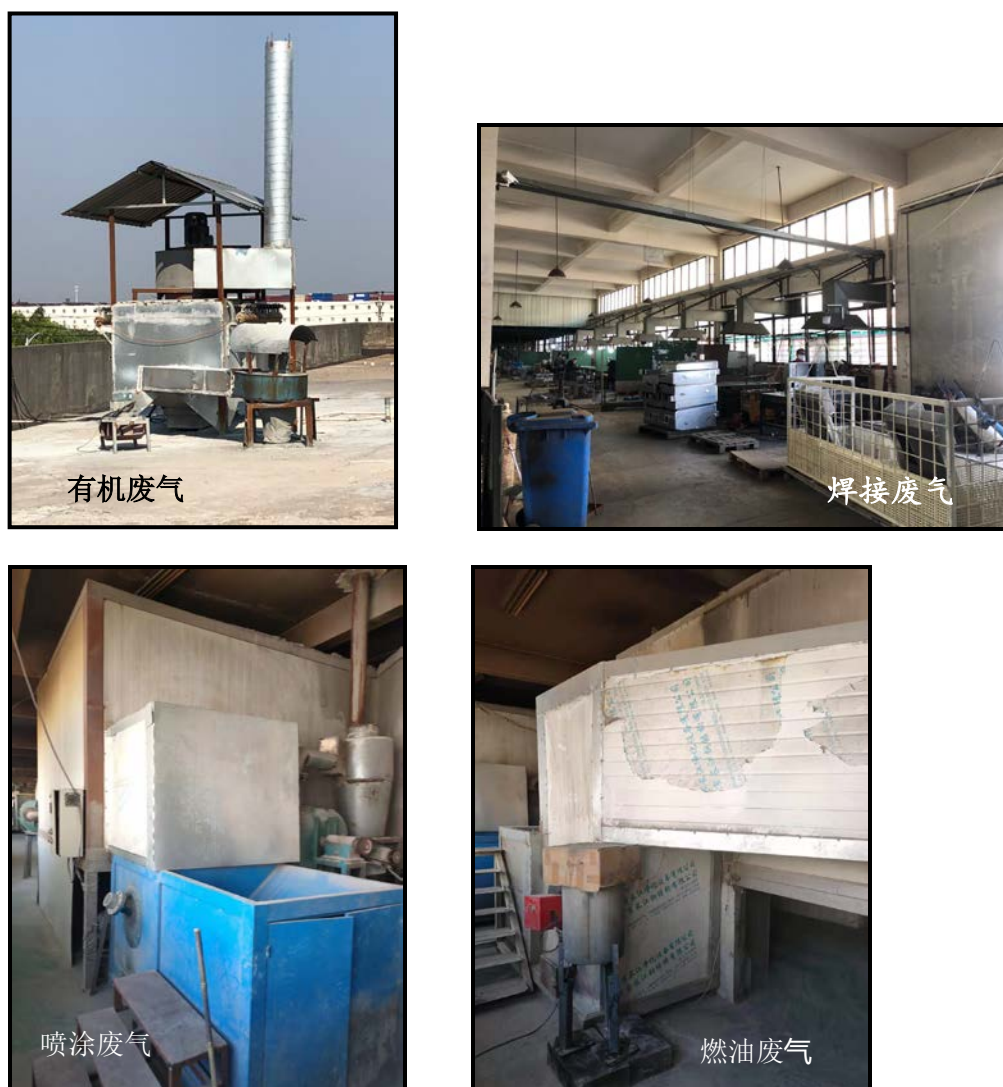
图 4-3 本项目主要废气治理设施
