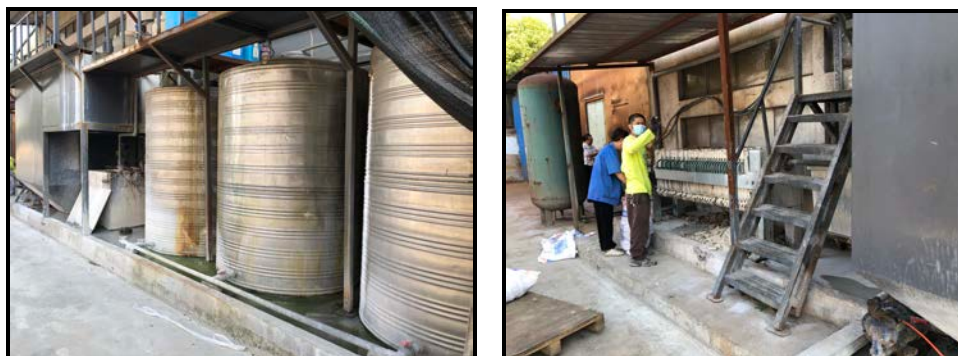
图 4-2 废水处理设施
