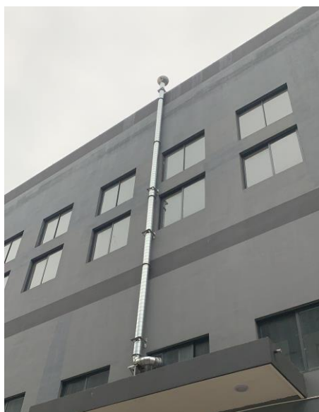
图4-2 本项目废气收集设施
