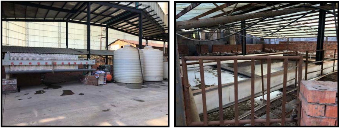
图 4-1 本项目主要废水治理设施
