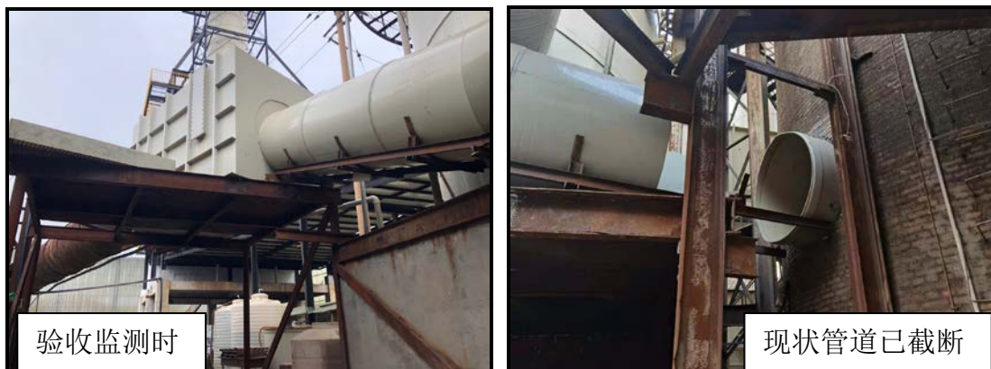
图 4-4 本项目恶臭废气处理设施
