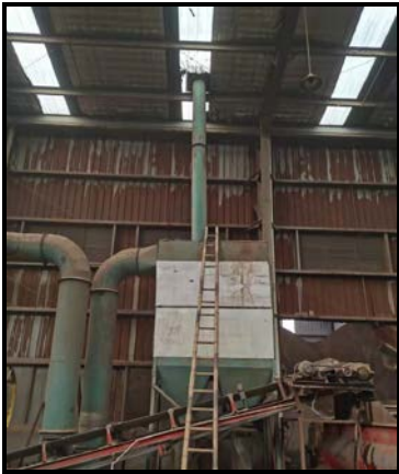
图 4-5 破碎粉尘处理设施
