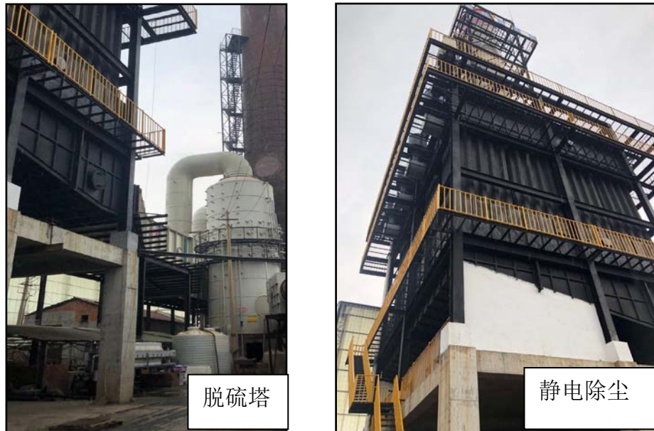
图 4-3 企业隧道窑烟气处理设施
