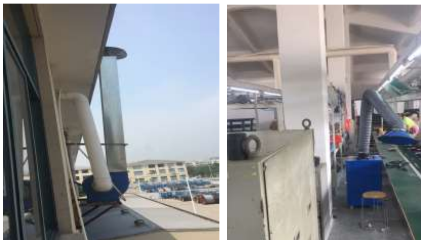
图 4-2 本项目废气处理设施图
