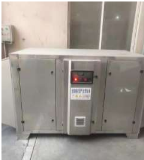
图 4-2 本项目主要废气治理设施
