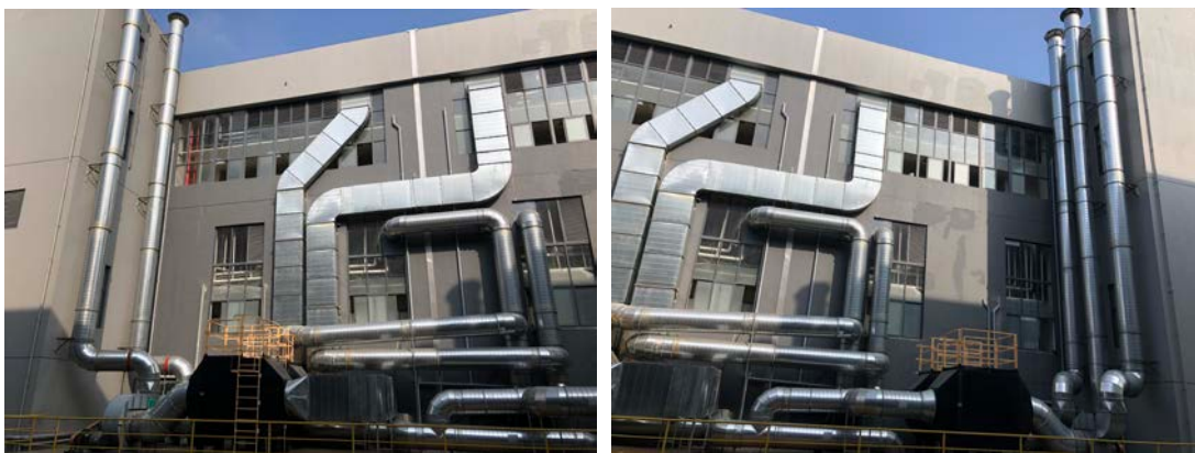
图 4-2 有机废气处理设施
