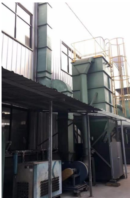
图4-2 本项目废气处理设施
