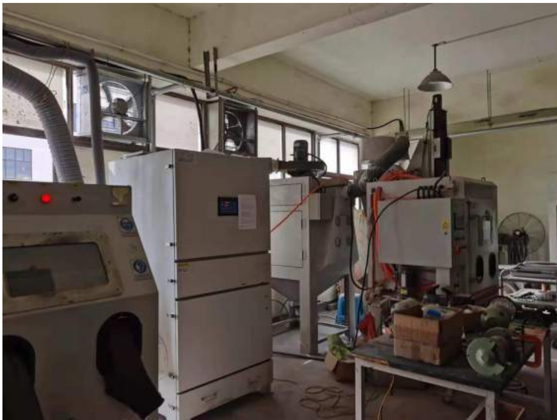
图 4-2 废气治理设施图片
