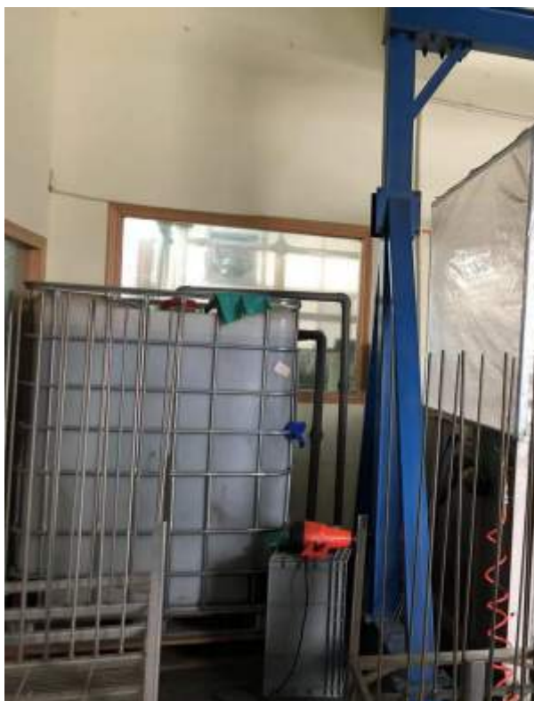
图 4-2 废水治理设施图片
