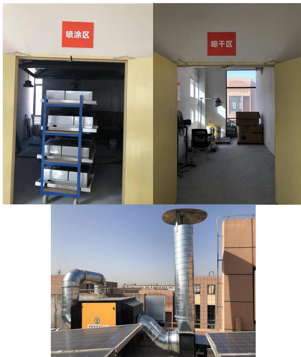
图 4-5 喷涂、晾干工序废气处理设施图片
