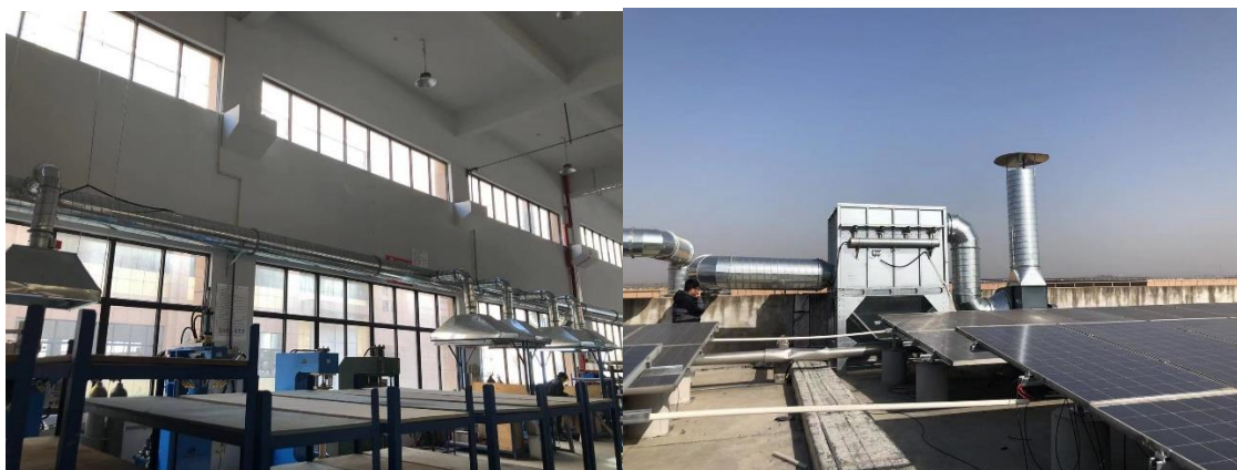
图 4-2 焊接工序废气处理设施图片
