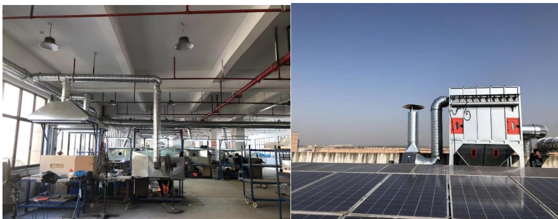
图 4-3 打磨工序废气处理设施图片
