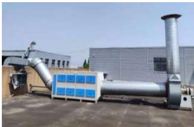
图 4-2 本项目废气处理设施图
