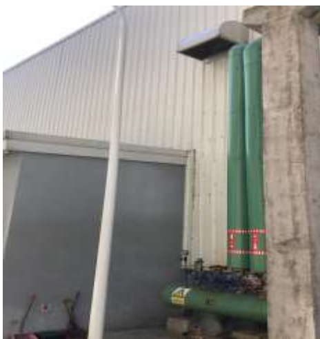
图4-4 本项目废气处理设施图片
