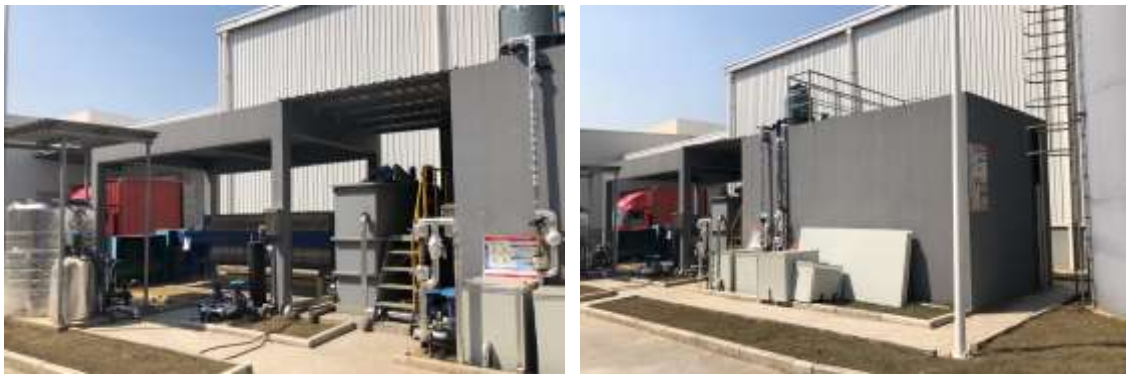
图 4-2 废水处理设施图
