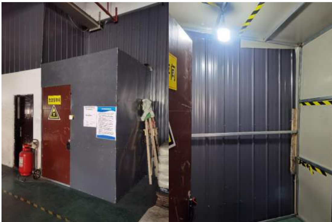
图 4-4 危险废物仓库
