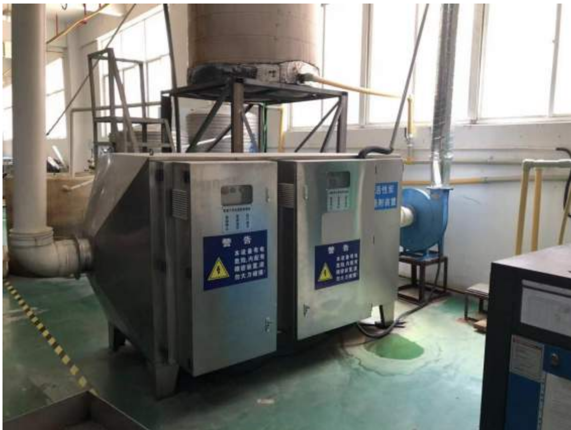
图 4-2 本项目有机废气处理设施图片
