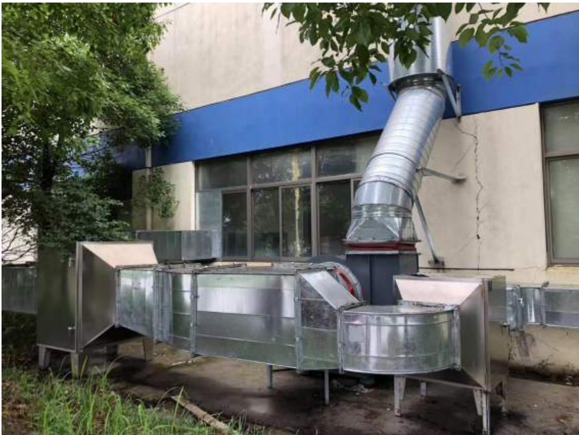
图 4-2 本项目废气治理设施图片
