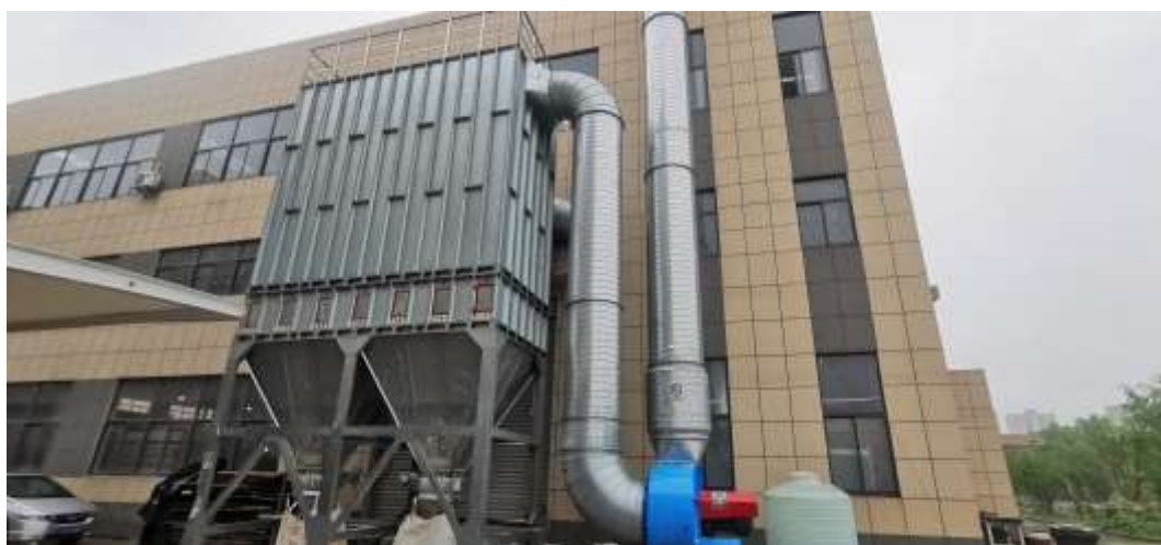
图 4-2 布袋除尘器废气处理设施
