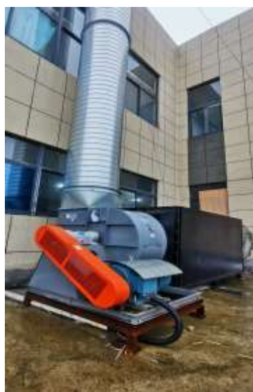
图 4-3 “UV 光解+活性炭”废气处理设施
