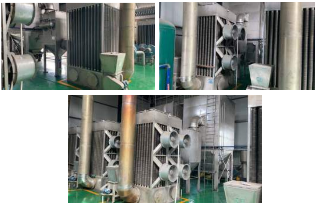
图4-2 废气处理设施
