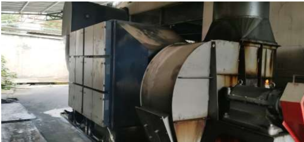
图 4-2 本项目油雾废气处理设施图
