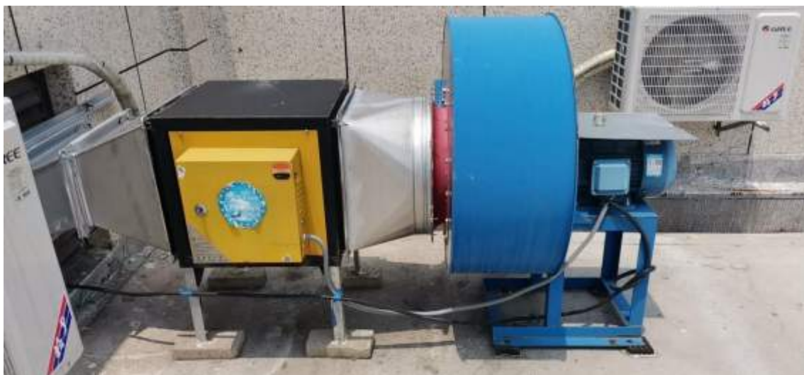
图 4-5 本项目食堂油烟净化装置处理设施图片
