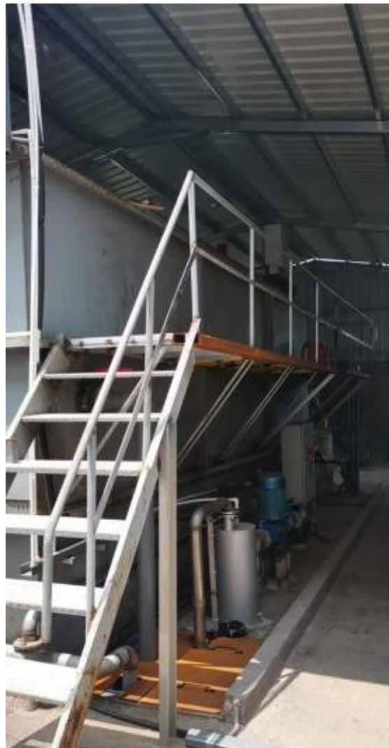
图4-2 生产废水处理设施图片
