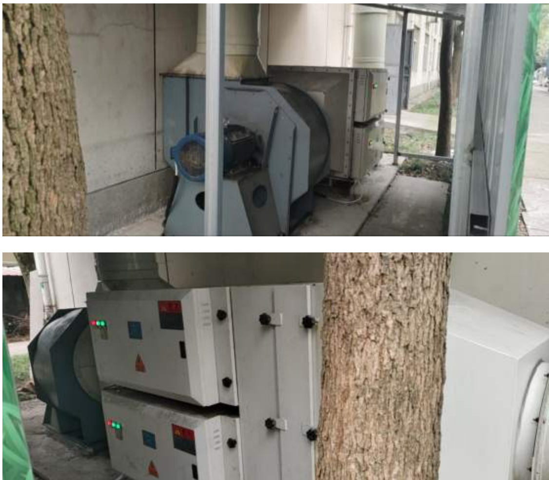
图4-2 本项目废气处理设施
