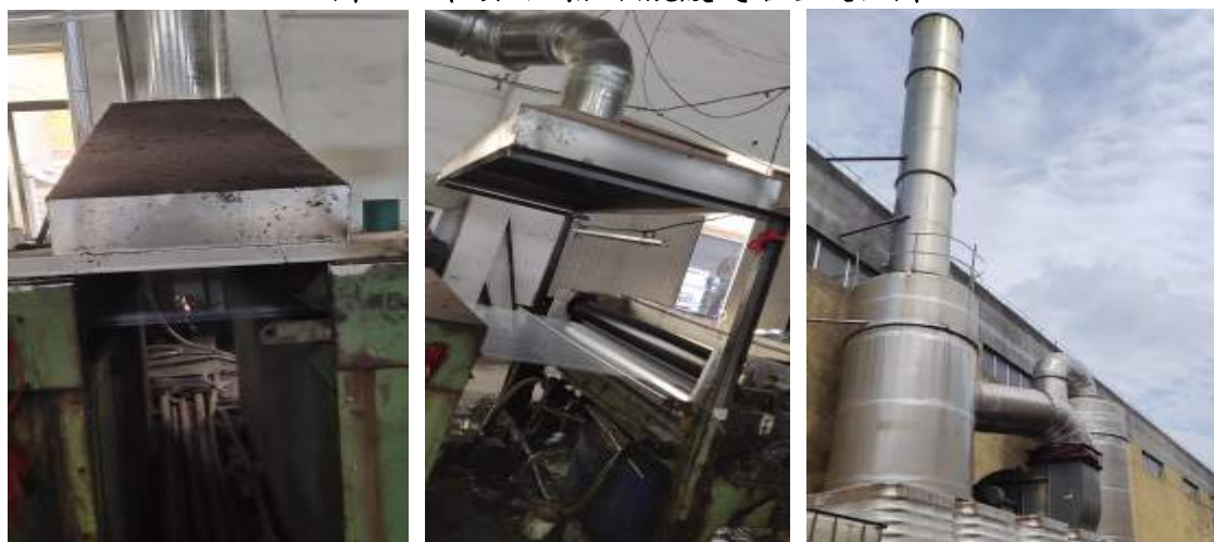
图 4-3 本项目浆水废气治理设施图
