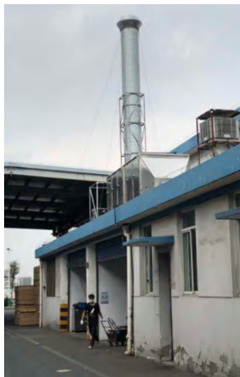
有机废气处理设施
