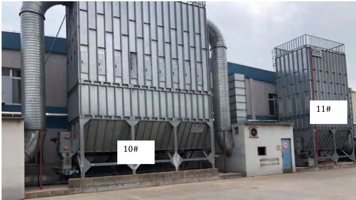
图 4-2 企业主要废气治理设施
