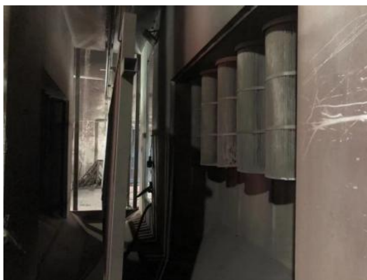
图 4-3 本项目喷塑废气自带除尘设施图片
