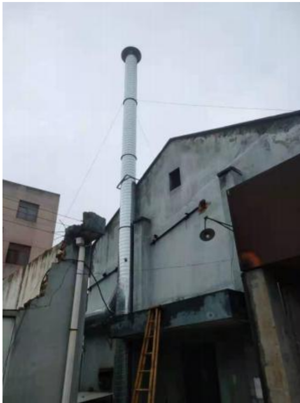
图 4-4 本项目废气排气筒（烘干有机废气+喷塑粉尘）
