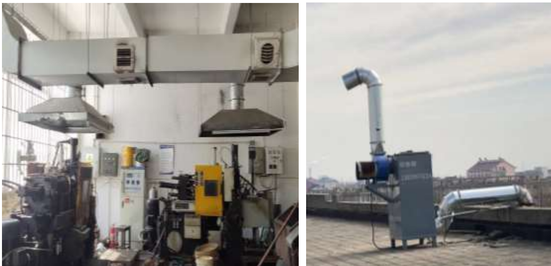
图 4-2 本项目主要废气治理设施
