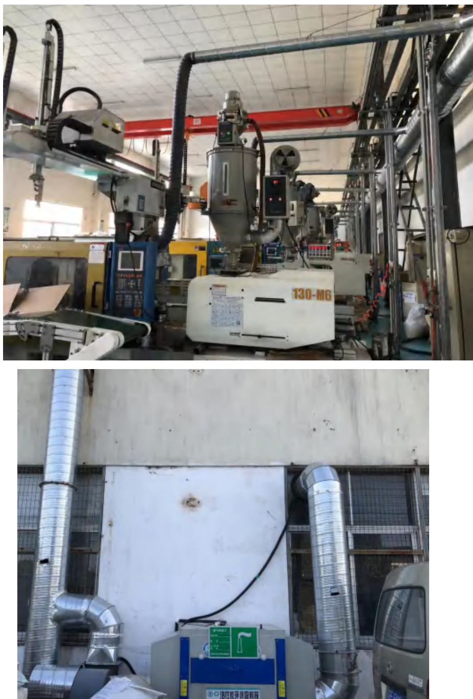
图 4-2 注塑工序废气处理设施图片
