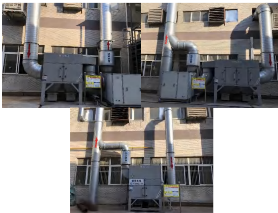
图4-5焊接废气治理设施图片
