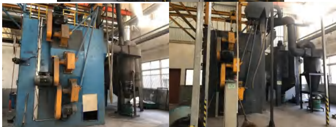
图4-9抛丸废气治理设施图片
