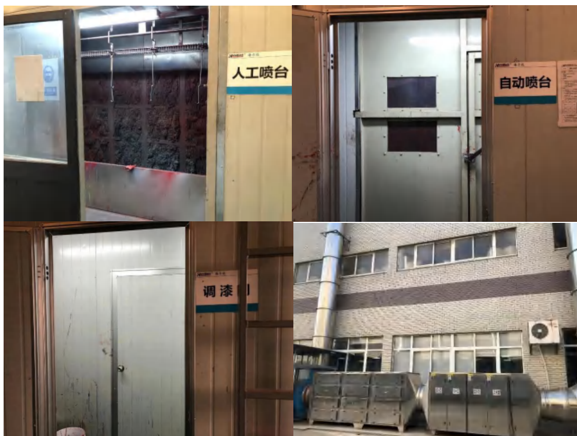
图4-4喷漆废气治理设施图片
