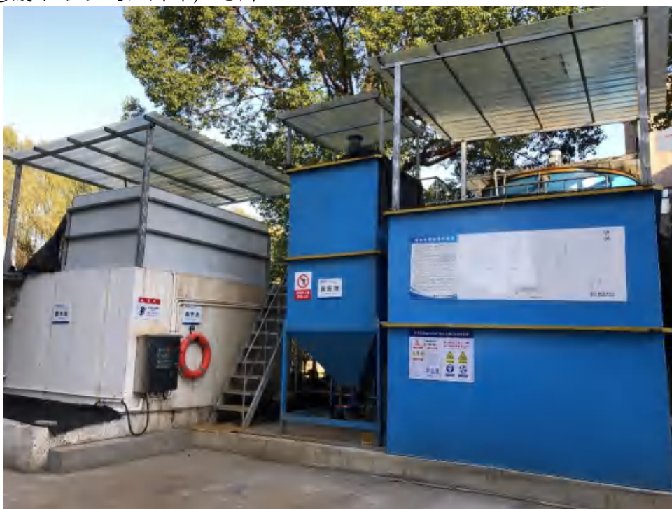
图 4-2 废水处理设施图片
