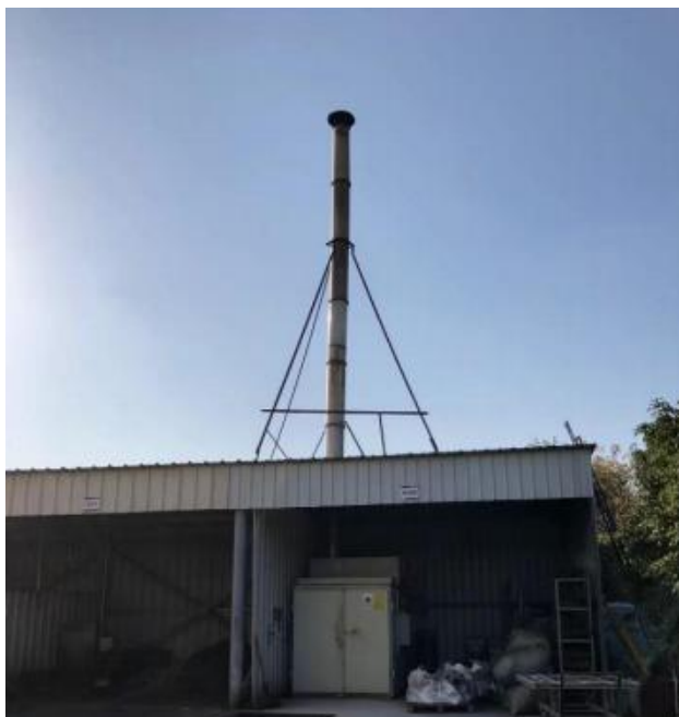
图4-10热洁炉燃烧废气排气筒图片
