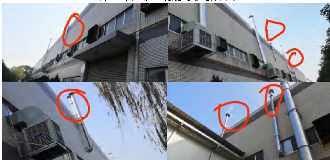
图4-11天然气燃烧废气排气筒图片
