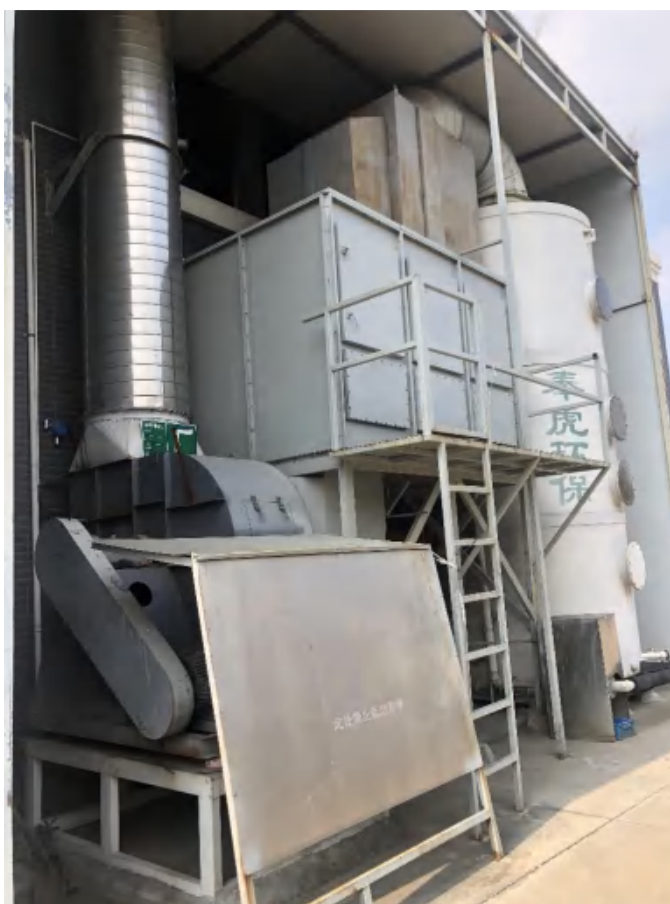
图4-2有机废气治理设施图片
