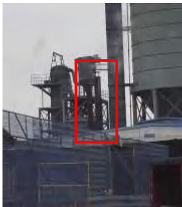
图 4-7 天然气排气筒
