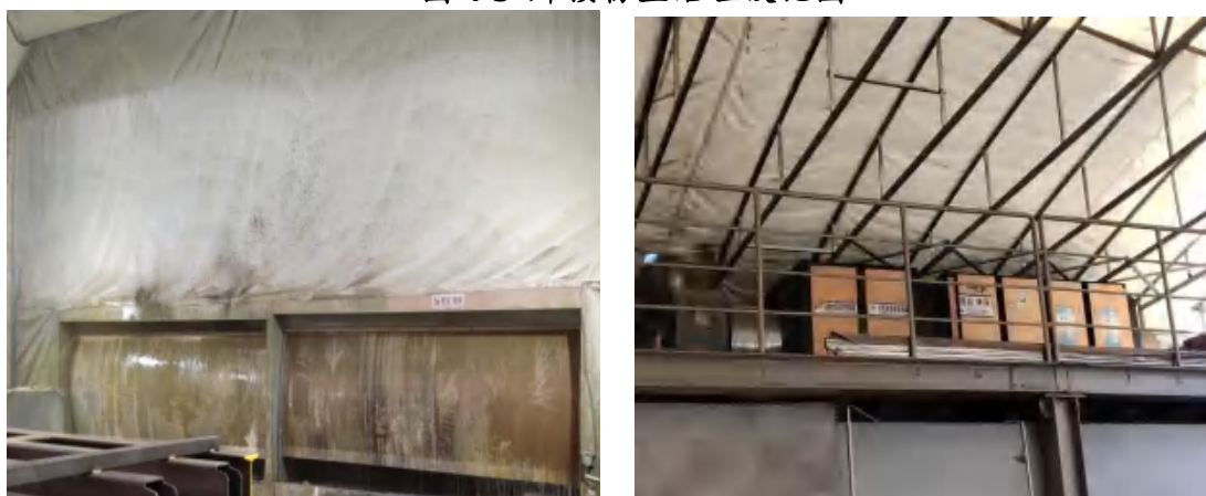
图 4-6 油漆废气治理设施图
