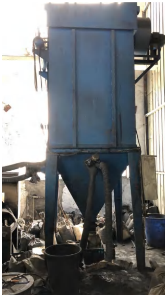
图 4-2 本项目投料混料、车加工工序粉尘处理设施图片
