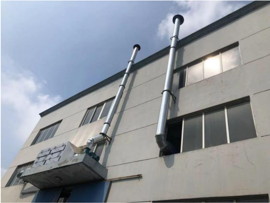
图 4-3 本项目烘干以及燃烧过程废气处理设施图片（左）
