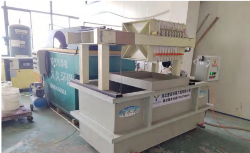
图 4-2 废水处理设施图
