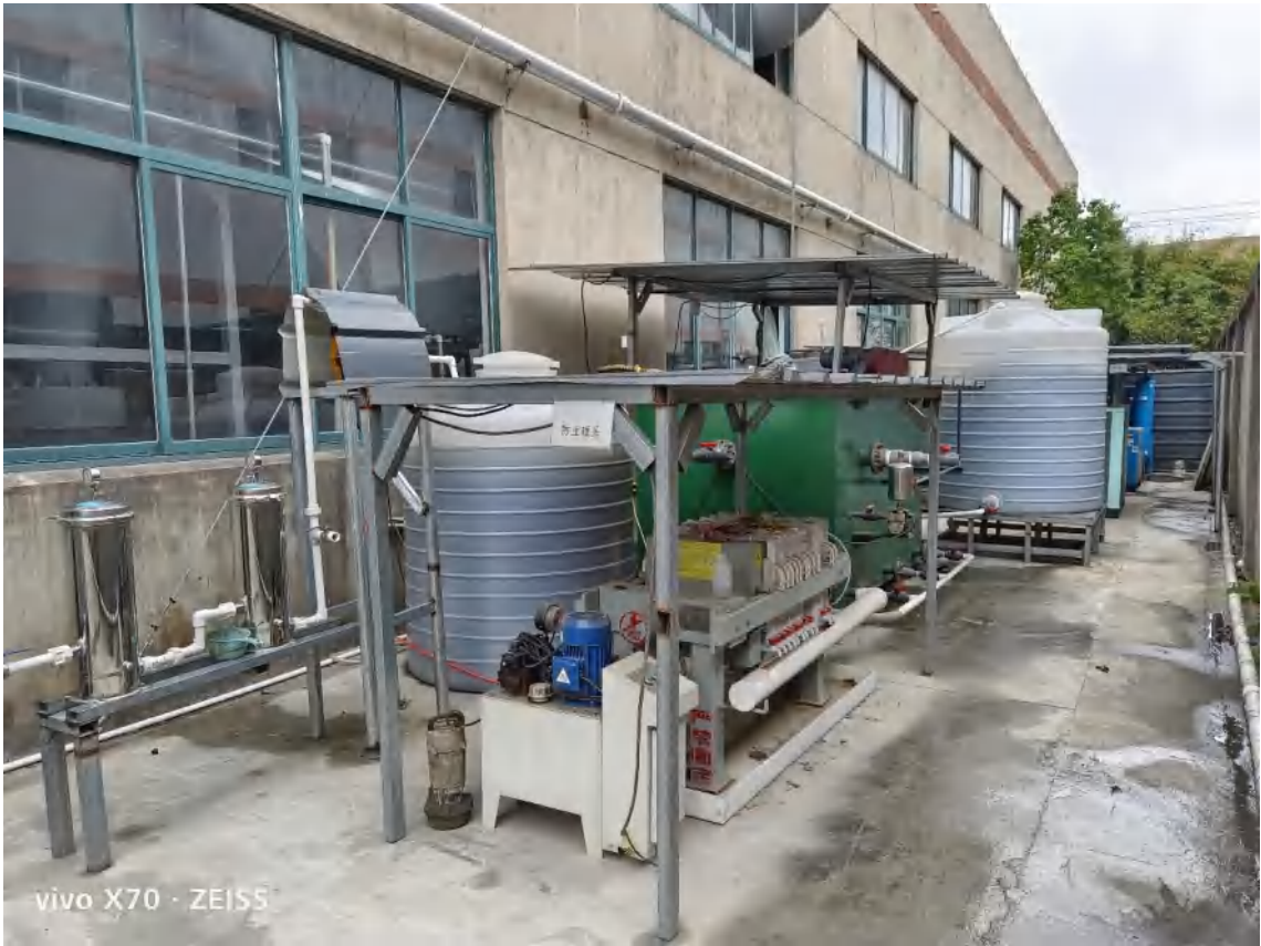
图 4-2 生产废水治理设施图片
