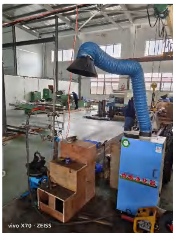
图4-5焊接烟尘废气处理设施图片
