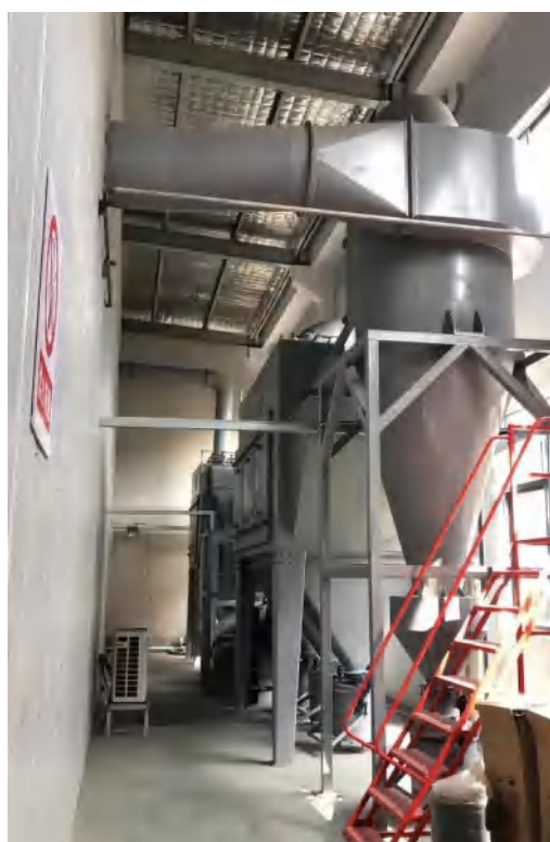
图4-4喷丸、喷粉废气处理设施图片
