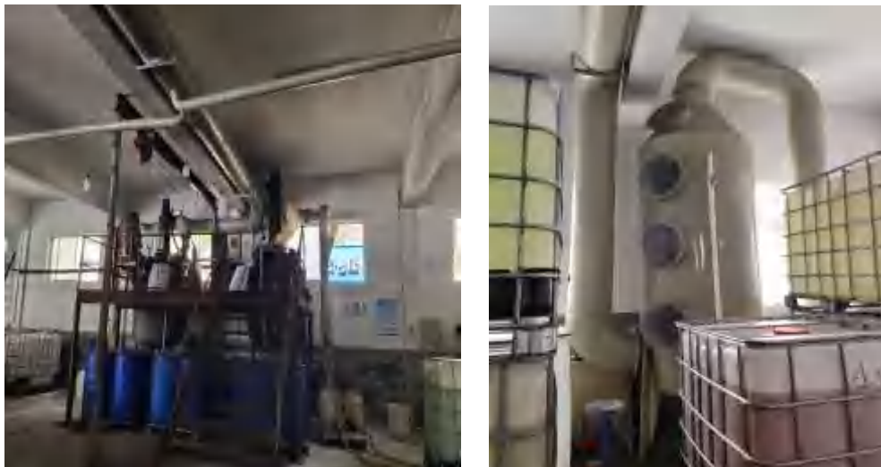
图 4-2 本项目复配废气治理设施
