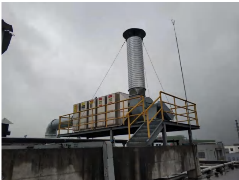
图4-2本项目注塑废气处理设施图片
